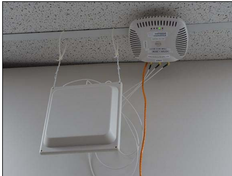
Figure 1 – Montage du PA1 (5 180 MHz) près du plafond
